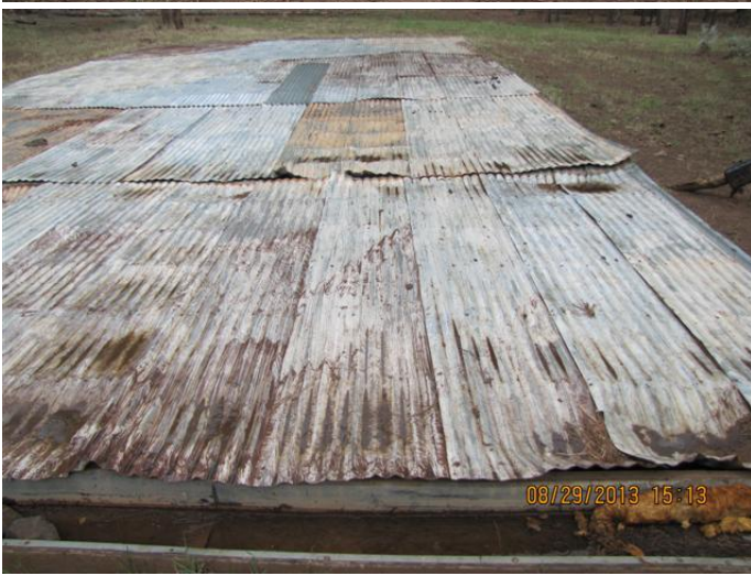
Apron material coming apart
